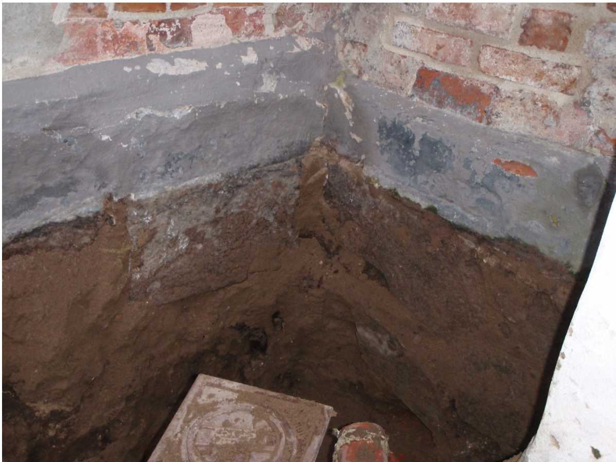
Fig. 4. Anslutningen för gammal och ny VA-ledning vid mötet för västlängan och kyrktornet. Foto år nordväst, Tony Björk.
