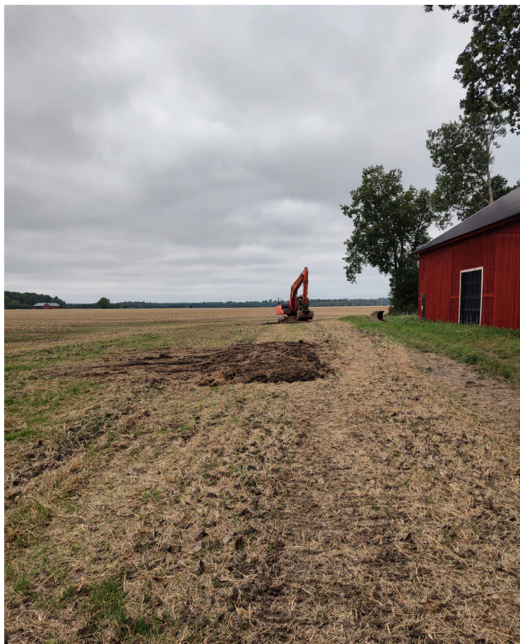
FIGUR 28. Sökschaktning i åkermarken inom arbetsyta nr 138. Till höger i bild är en av ladorna som uppfördes i samband med anläggandet av ett beredskapsflygfält under 1940-talet. Foto mot väster: Fredrik Andersson, SAU.
