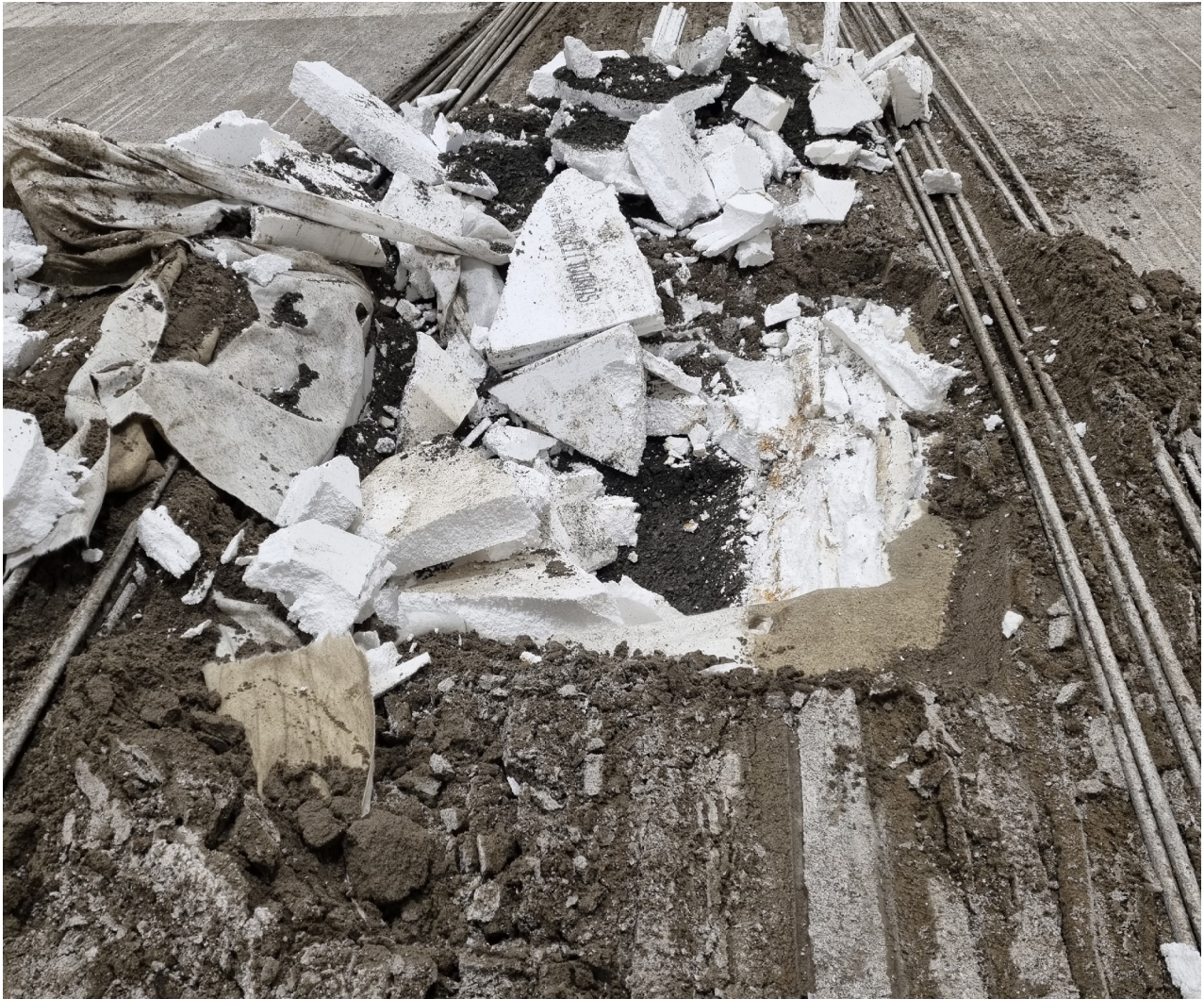
Figur 4. Ett av de öppnade schakten inne i ishallen. Foto: Astrid Lennblad
