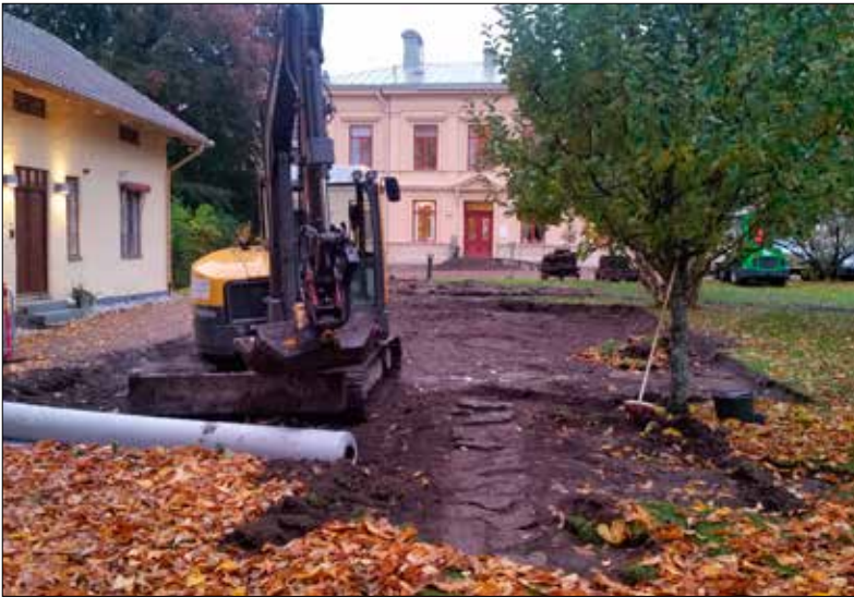
Figur 1. Schakt 1 med den påträffade stenläggningen (A1). Bilden är tagen från norr. Foto: Patrik Gustafsson Gillbrand 2016, Sörmlands Arkeologi AB.
