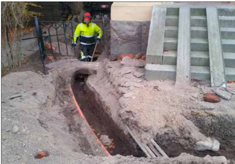
Figur 14. I schakt 4 framkom rikligt med VA- och elledningar. Bilden är tagen från nordväst. Foto: Patrik Gustafsson Gillbrand 2016, Sörmlands Arkeologi AB.
