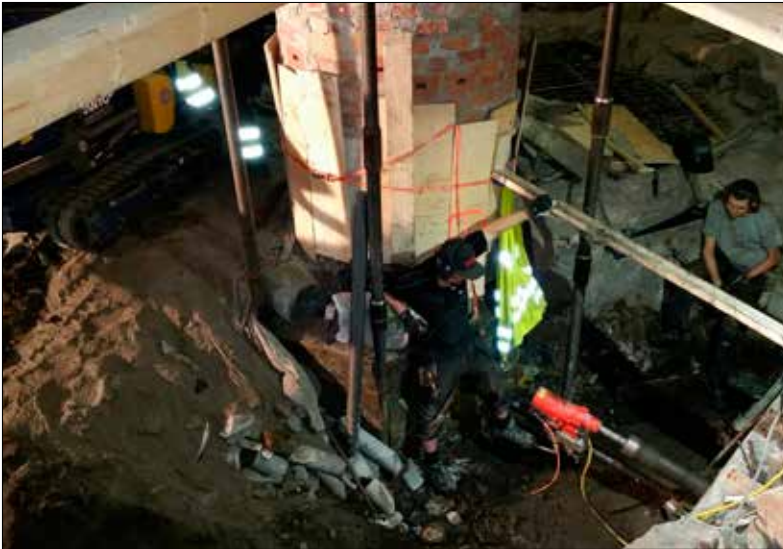
Figur 4. Arbetsutrymmet var mycket begränsat på insidan av Kanonrondellen. Förutom en arkeolog fanns två anläggningsarbetare som utförde schaktningen samt två borrarare. Bilden är tagen från sydöst. Foto: Patrik Gustafsson Gillbrand 2015, Sörmlands Arkeologi AB.
