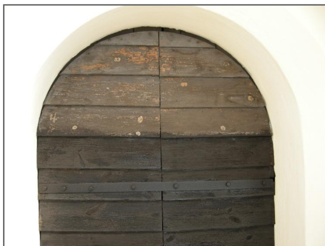
Figur 8. Ljudluckorna var i behov av omtjärning.
