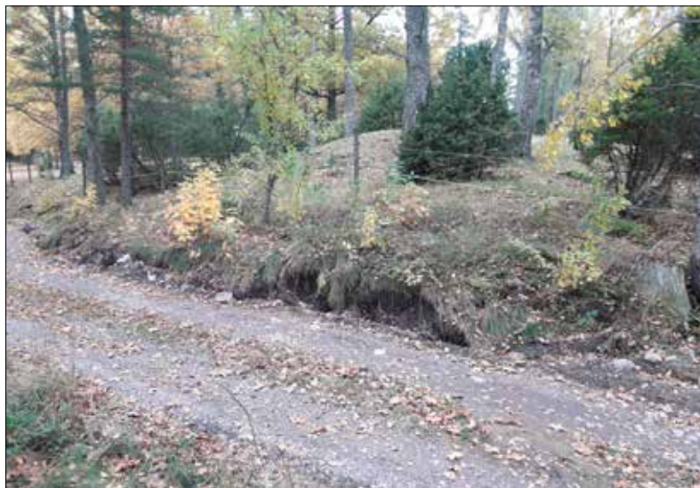
Figur 2. Schakt som skadat grav 3. Man kan tydligt se den blottade jorden. Bilden är tagen från sydsydöst. Foto: Patrik Gustafsson Gillbrand 2017, Sörmlands Arkeologi AB.
