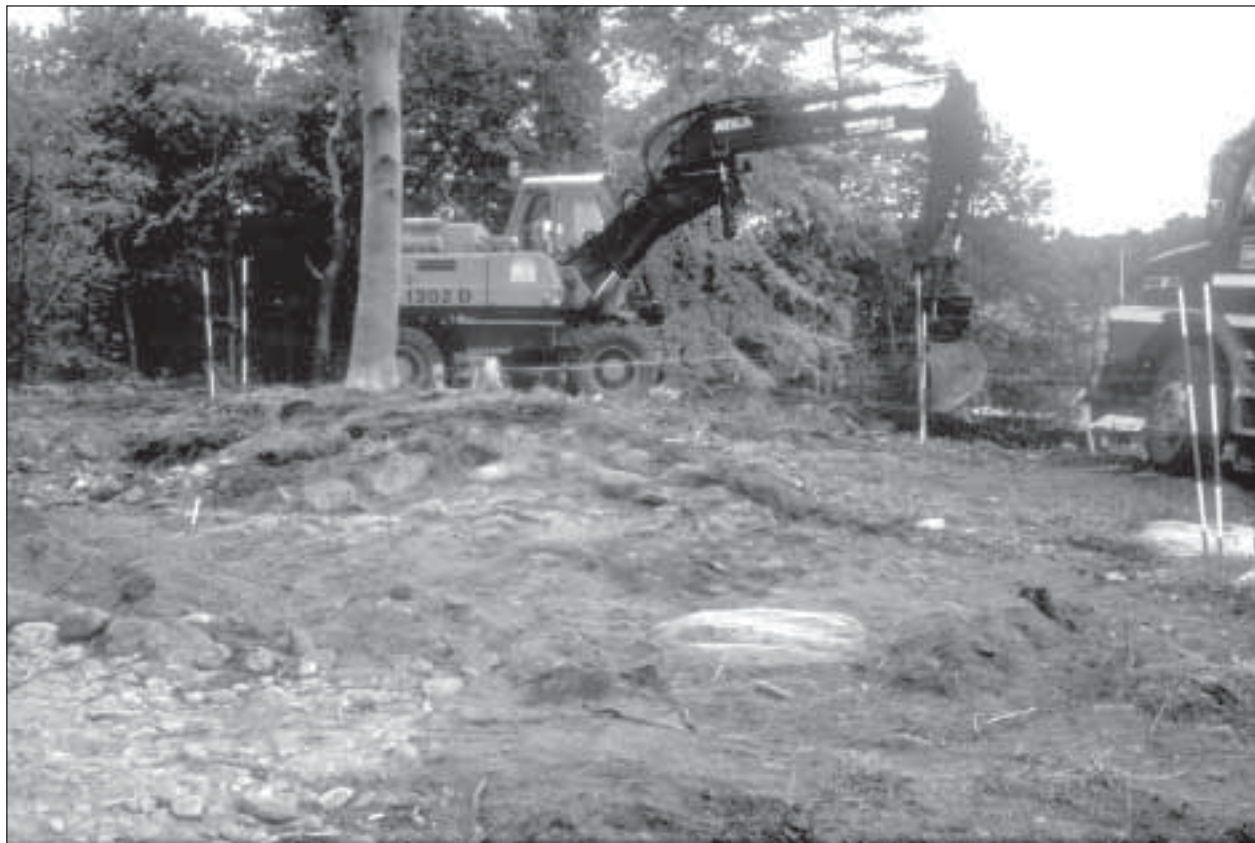
Fig. 4. Undersökningen av gravhögen genomfördes delvis med hjälp av grävmaskin. Foto: Glenn Johansson.
