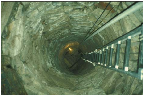
Figur 4. Den upplysta brunnen med Räddningstjänstens stegar, pumpslang och elkabel på plats.
