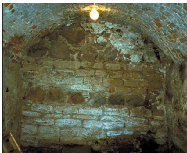
Figur 7. Södra väggens kalkstensmurverk med mönstermurning av gråstenar. Skiftens lutning visar att väggen satt sig i västra hörnet.
