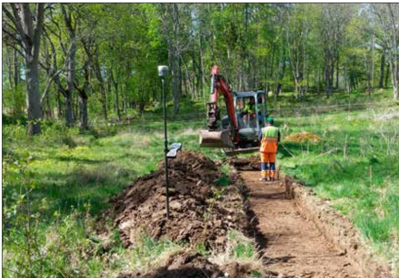
Schakt 9 i den södra delen av utredningsområdet. Fotograferad mot nordväst. Foto: Lars Norberg 2016, Sörmlands Arkeologi AB.
