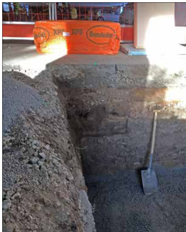
Figur 5. Hisschaktet inne i P-huset Akilles. Foto från S, Helén Romedahl, ÖM.
