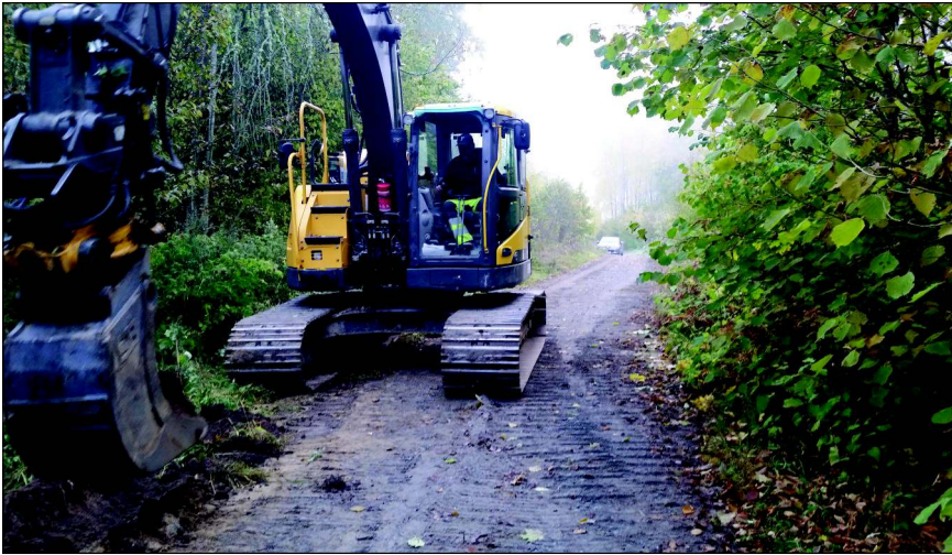
Figur 1. Översiktspåtag över den planerade schaktsträckan. Schaktet öppnades längs den norra ytterkanten av en grusväg. I bakgrunden står en bil parkerad intill den transformator som utgjorde den borte änden av schaktet. Bilden är tagen från sydväst. Foto: Patrik Gustafsson Gillbrand 2015, Sörmlands Arkeologi AB.
