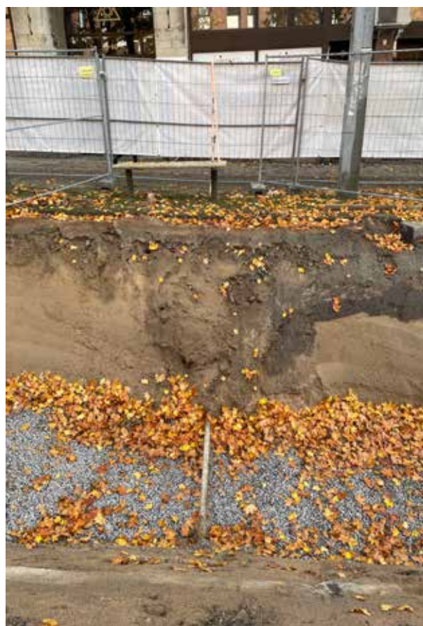
Figur 5. Den södra schaktväggen utgjordes av sand. Här syns en nedgrävningskant för ett äldre rör som syns mot botten av schaktet. Foto taget från norr. Foto: Anna Beckman
