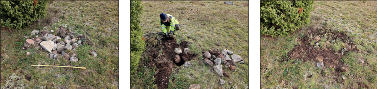
Figur 2-4. Skada 1 före under & efter återställning. Foton mot öster: Lars Norberg 2025, Sörmlands Arkeologi AB.
