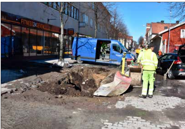
Figur 1. Situationsbild vid ankomsten till det öppnade schaktet med vattenläckan i Västra Trädgårdsgatan. Bilden är tagen från sydöst. Foto: Lars Norberg 2018, Sörmlands Arkeologi AB.
